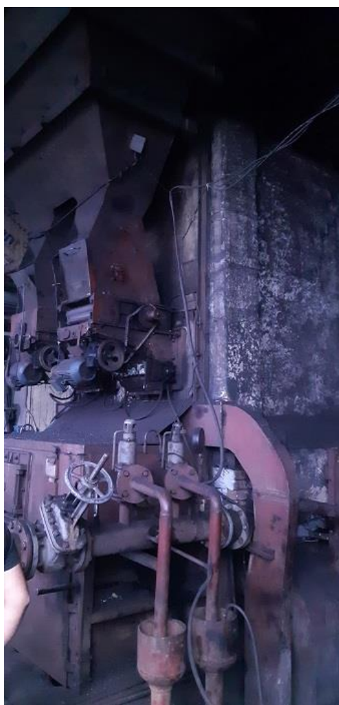
Рисунок 4. Водогрейный котел №1 марки КВ-ТС-7,56-115 на котельной с. Хову-Аксы
