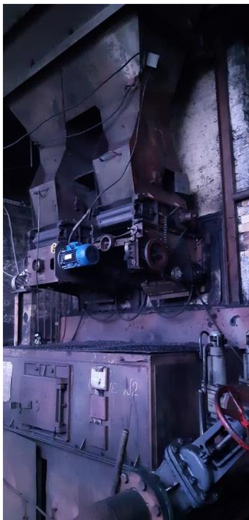
Рисунок 5. Водогрейный котел №2 марки KB-TS-4,65-115 на котельной с. Хову-Аксы
