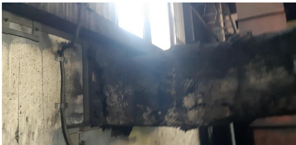
Рисунок 8. Тракт уходящих газов водогрейного котла №2 на котельной с. Хову-Аксы
